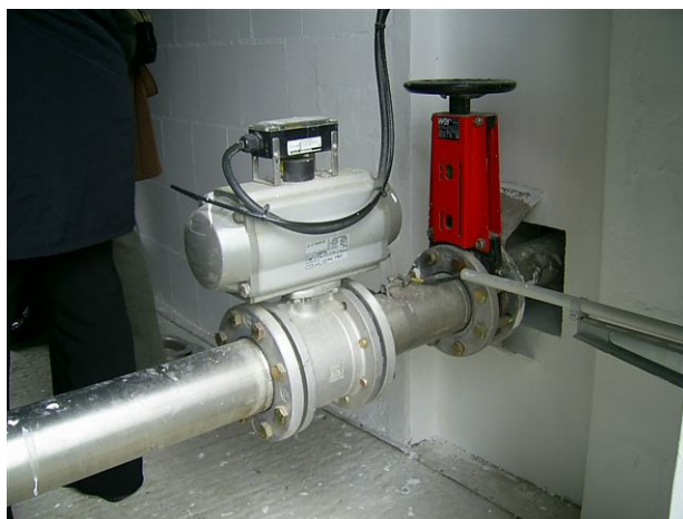
Vanne automatique complétée par une vanne manuelle. Source : Bio-Nrj.
